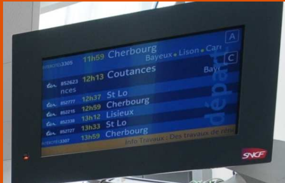
Modernisation de l'information voyageurs et vidéosurveillance Gare de Caen
