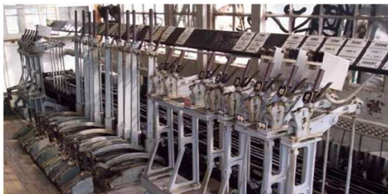
Poste de type SAXBY basé au poste 2 de Gisors datant de 1920 (un des plus anciens sur la région)
